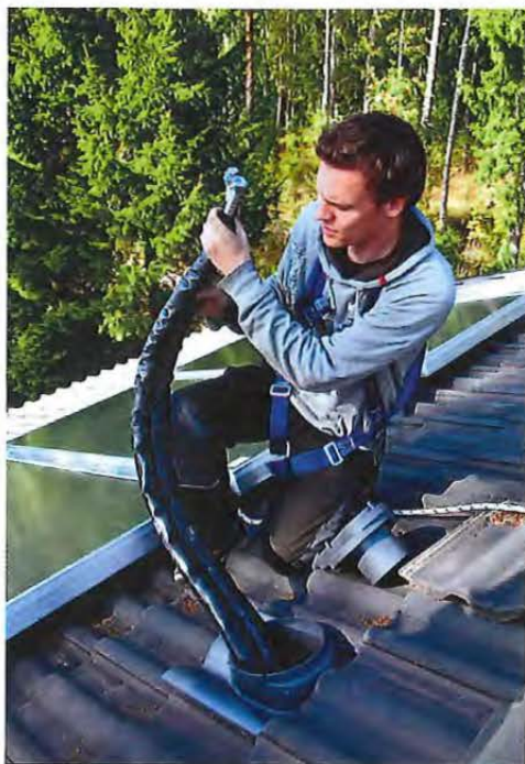
Putki muodostaa keräimien kautta suljetun silmu-kan. Neste tulee kylmänä ja lähtee kuumana.
