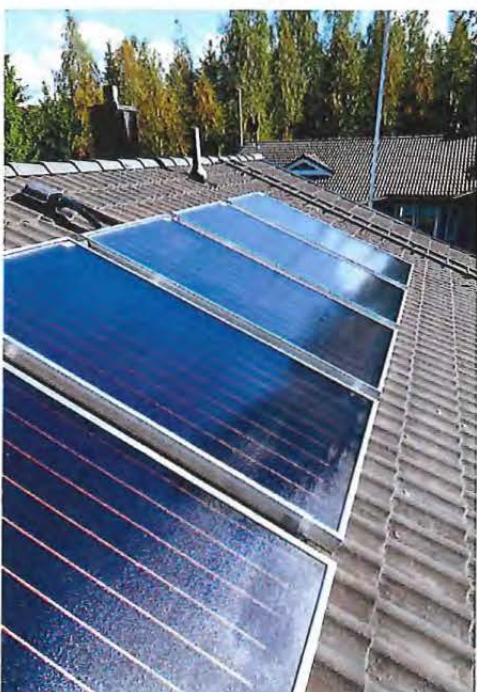
Keräimet lepäävät autotallin katolla. Paikka on aurinkoinen, ja lämpökeskus on suoraan alapuolella.
