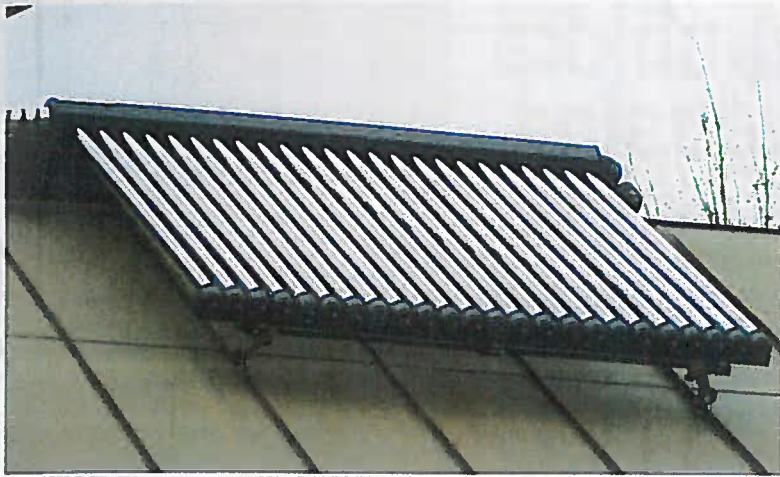
Aurinkolämpöjärjestelmä soveltuu hyvin osaksi muuta lämmitysjärjestelmää hybridijärjestelmänä, jolloin aurinkolämmöllä korvataan ostoenergiaa tai varastoidaan lämpöä.
