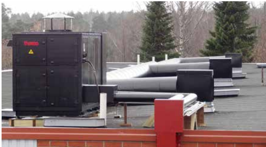
Therecon lämmöntalteenotto -laitteistot sijaitsevat rakennusten katoilla.
