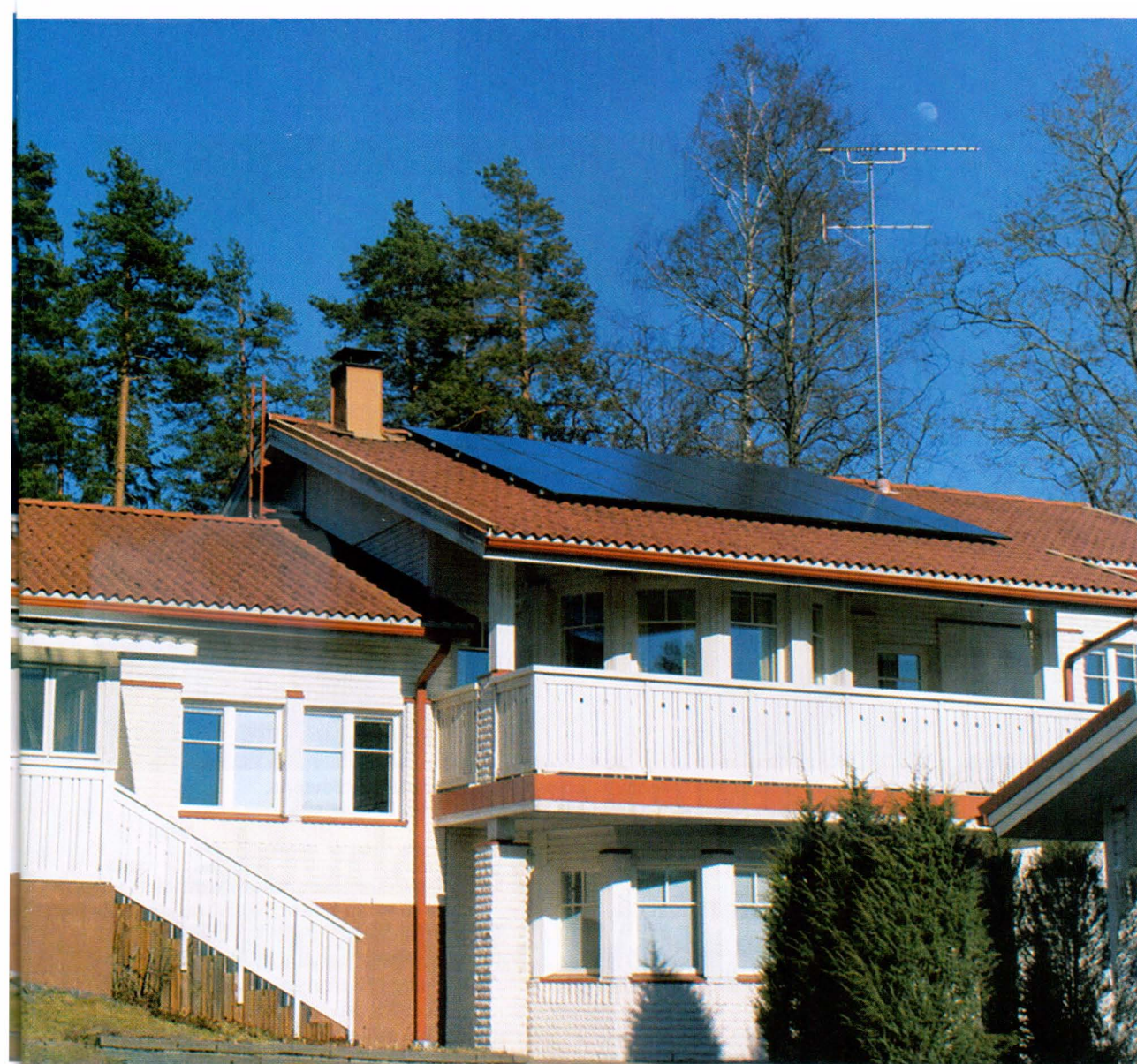
Tapio Tuomen talon katolla on aurinkopaneelit ja aurinkokeräimet. Keräimiä on kolme kappaletta, yhden keräimen koko on kaksi neliötä.
